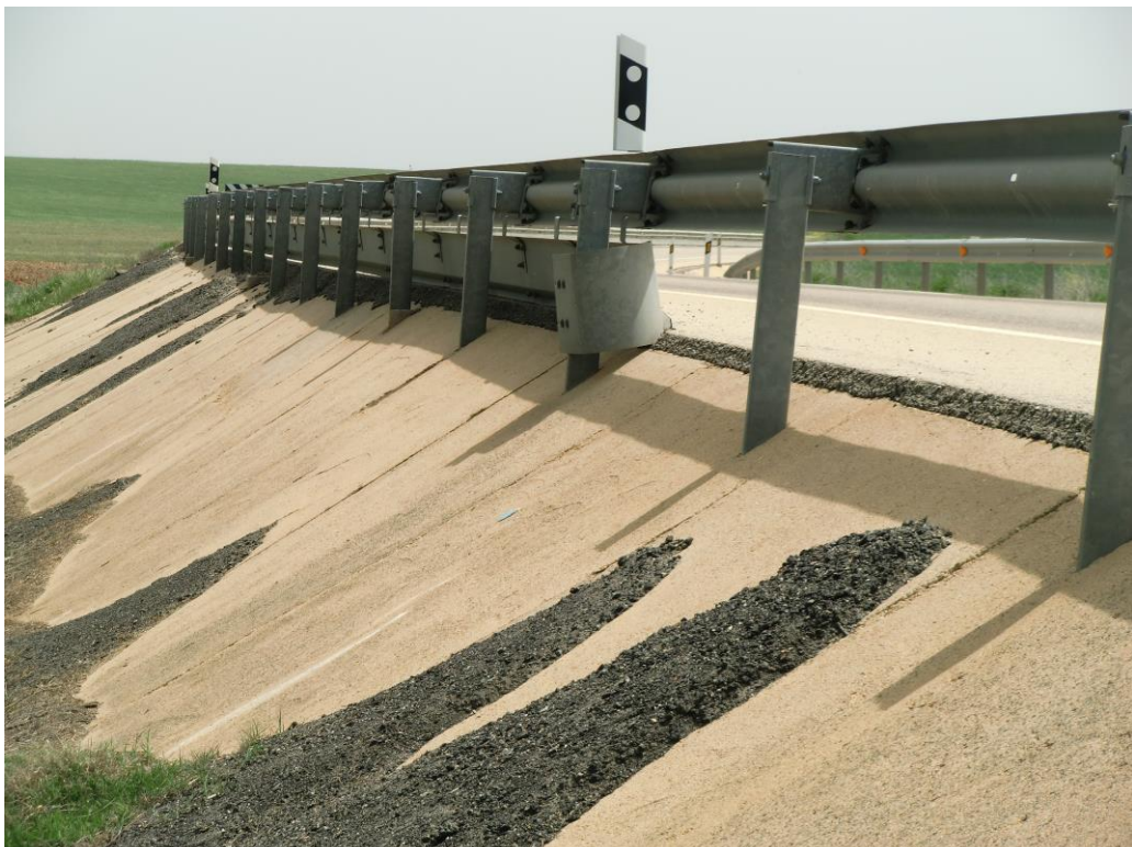
Ejemplo SPM mal instalado (Modificándose su comportamiento dinámico ante el impacto)
