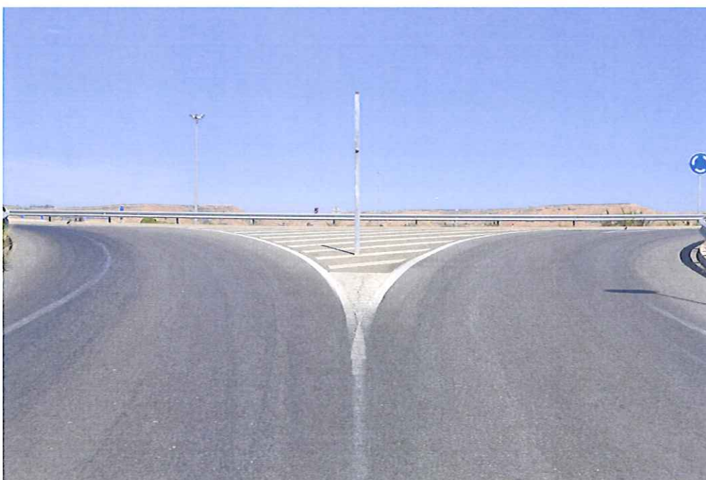
Fotografía observando el poste metálico vertical sin señal, ya que no ha sido repuesta
