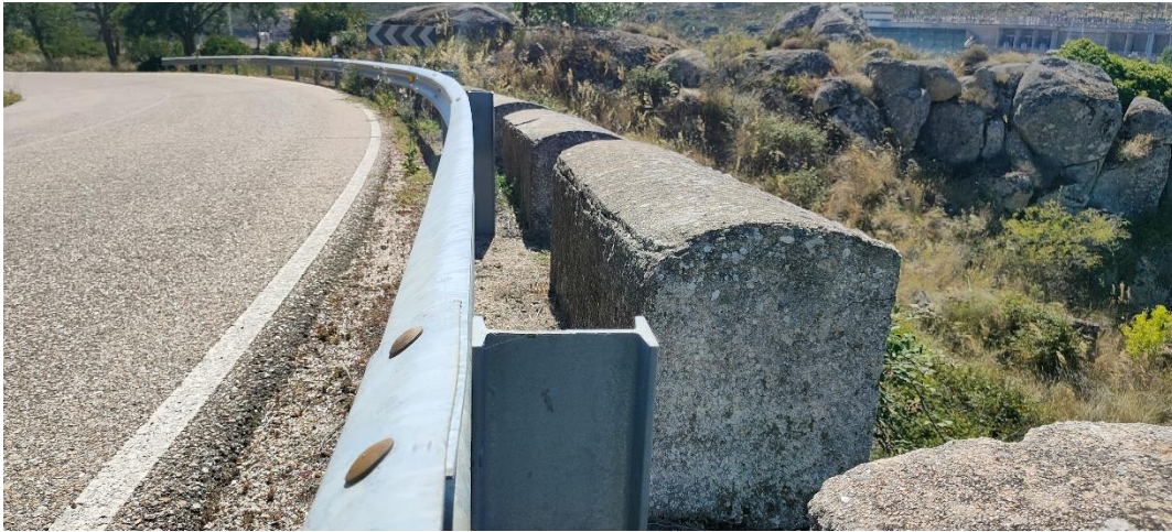
Fotografía 4. Zamora. Ejemplo de mecanizado, solapamiento incorrecto y ausencia de tornillería.
